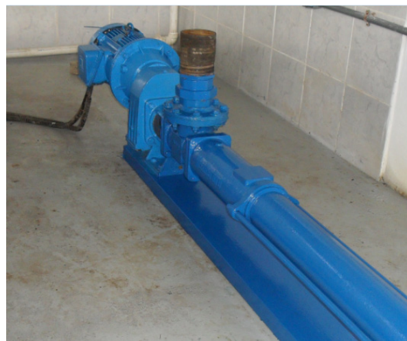
FIGURA 18 BOMBA HELICOIDAL DE 25HP E 12KGF/CM 2 DE PRESSÃO DE DESCARGA
