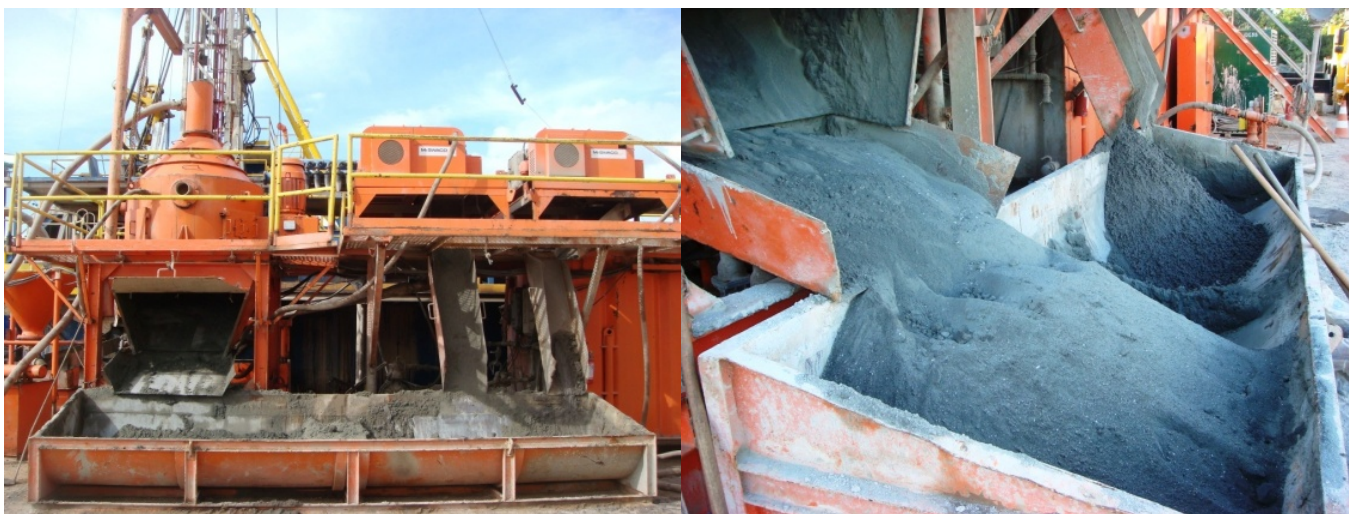
FIGURA 9 SISTEMA DE RECUPERAÇÃO DO FLUIDO DE PERFURAÇÃO, UTILIZADO PELA SONDA BCH 05, NO POÇO DE PROSPECÇÃO 7-MGP 98-D BA, NO CAMPO DE MIRANGA, NA BACIA DO RECÔNCAVO, MUNICÍPIO DE POJUCA, ESTADO DA BAHIA.
