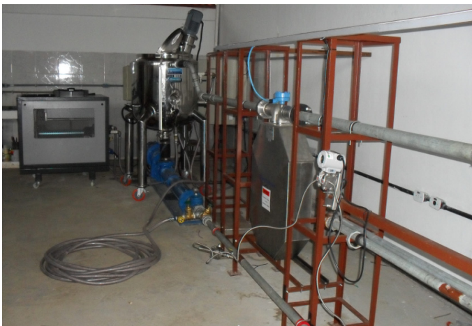
FIGURA 17 UNIDADE DE SIMULAÇÃO DE ESCOAMENTO DE FLUIDOS (USEF)
