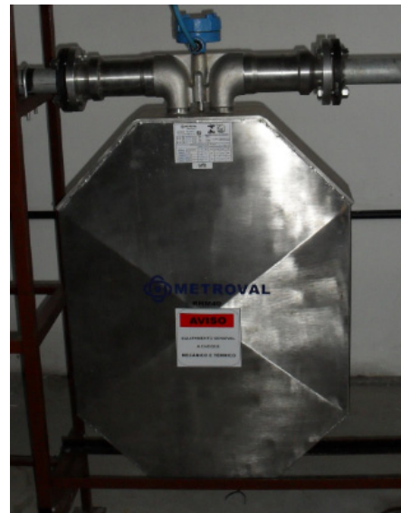
FIGURA 16 MEDIDOR DE VAZÃO E DENSIDADE CORIOLLIS DA UNIDADE
