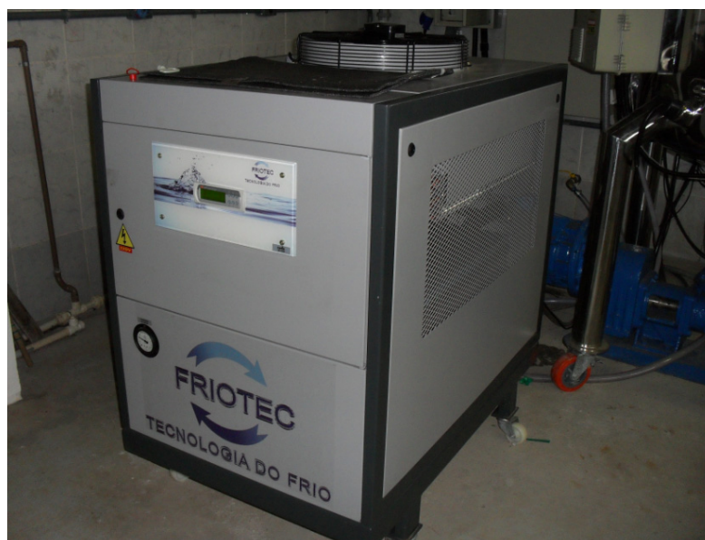
FIGURA 20 CHILLER DA UNIDADE EXPERIMENTAL
